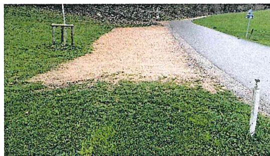
Ist-Zustand Parkplatz von unten
